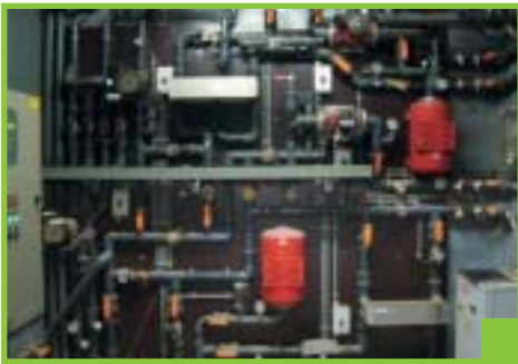
PLC (l.) met leidingen en warmtepomp (r.).
